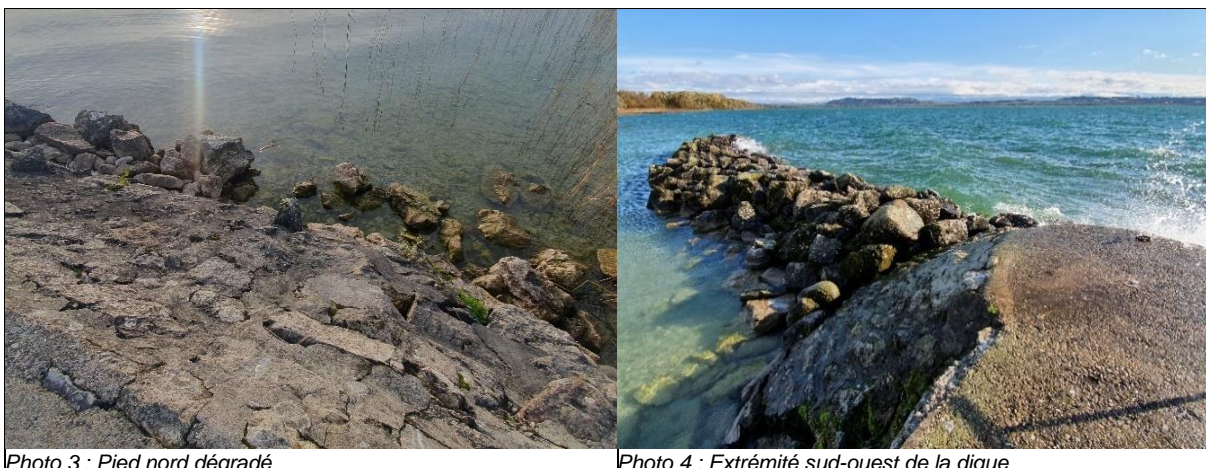
Photo 3 : Pied nord dégradé
