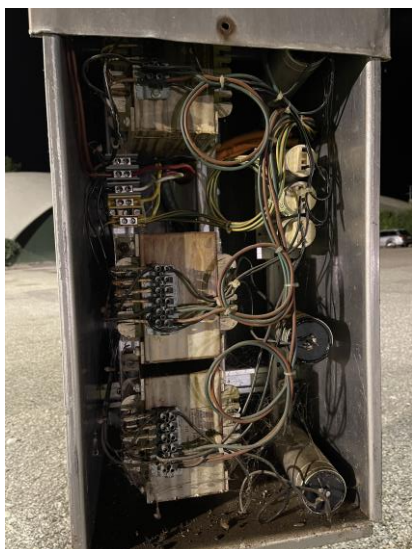
Alimentations actuelles des lampes au pied du mât dans un caisson en aluminium
