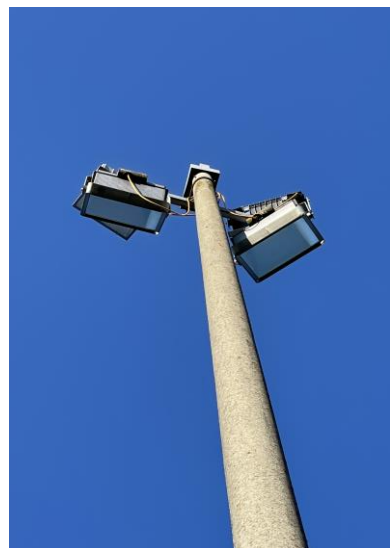
Luminaires et support en tête de mât
