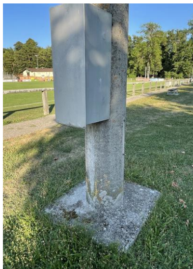
Socle en béton et boîtier électrique (ballast)
