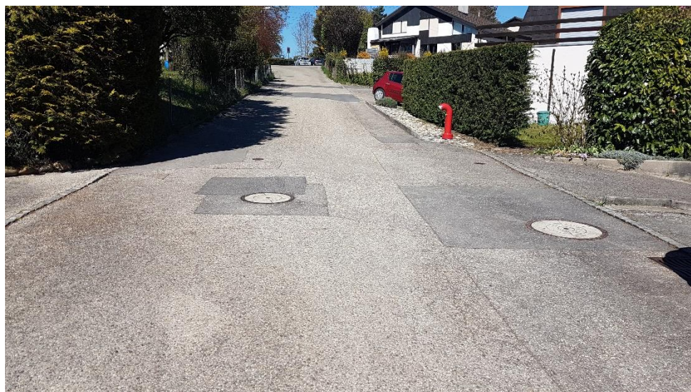
Fig.1 État de la chaussée
