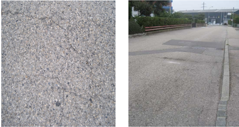
Figure 5 : usure, fissures et réparations à la rue des Couviers
