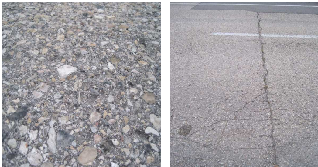
Figure 6 : usure, fissures longitudinales et réparations à la rue du Closel
