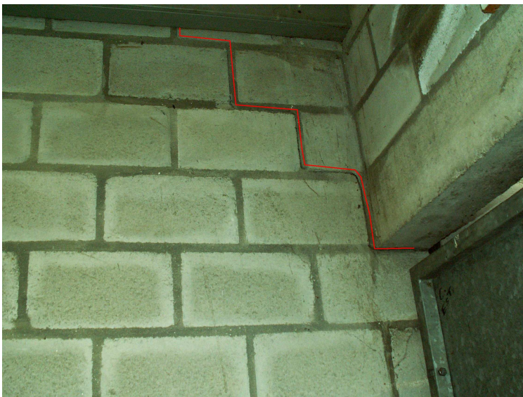
Vue 5 : diverses fissures
